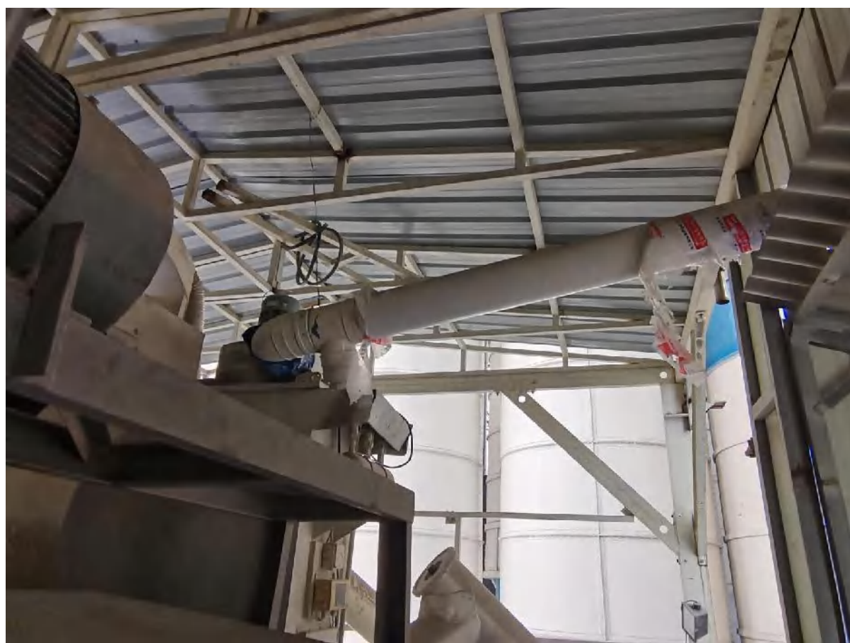
商品砼加工搅拌废气处理
